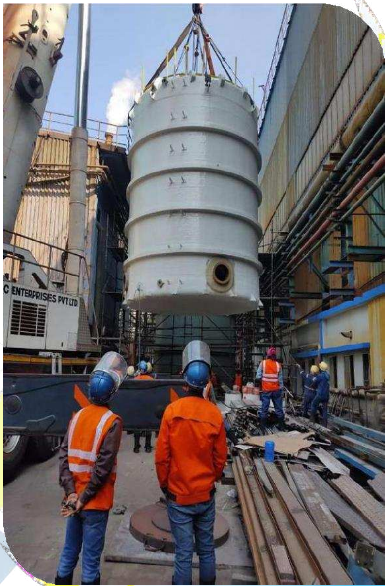
TATA STEEL LTD INDIA, 220 KL TANK
